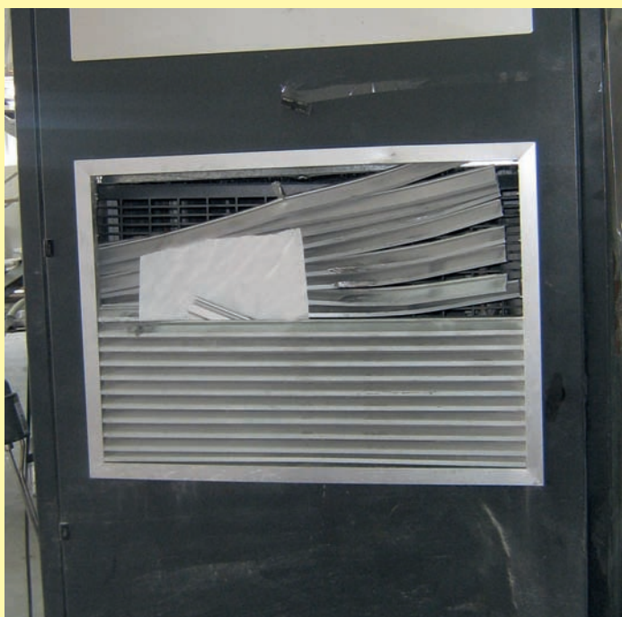
Blechschäden am Gehäuse der Feuchtwasserszentrale lassen nicht hinreichend auf Schäden im Inneren des Blechgehäuses schließen.
