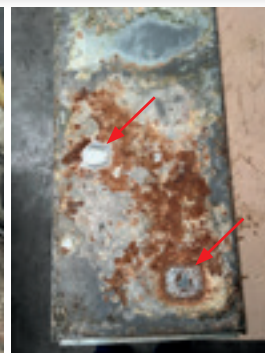
3. Stark korrodiertes Bodenblech hin zur Fundamentbodenplatte (roter Pfeil: Position des Stellfusses auf der Rückseite des Bleches).
