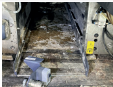
2. Extrem ausgeprägte Korrosionsprodukte auf der Fundamentbodenplatte unterhalb der Bogendruckmaschine.
