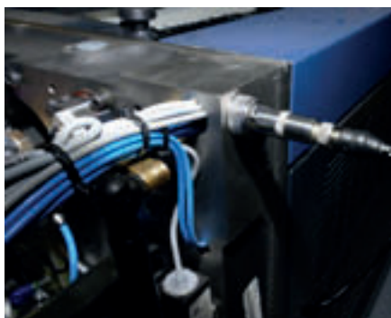
Schwingungsaufnehmer in Längsrichtung an der Seitenwand eines Druckwerks, bedienseitig.
