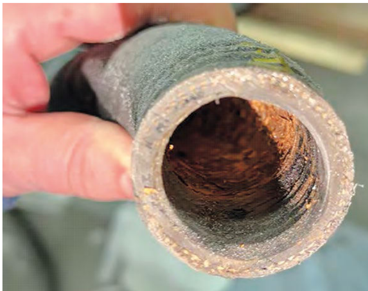
Abbildung 4: ausgebaute Elastomerverrohrung mit mächtigem Korrosionsanfall im Inneren.
