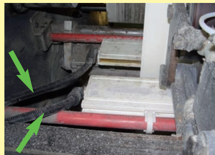
Stranghaftung mit Hochspannungskabeln (grüne Pfeile), die den Brand verursachten.
