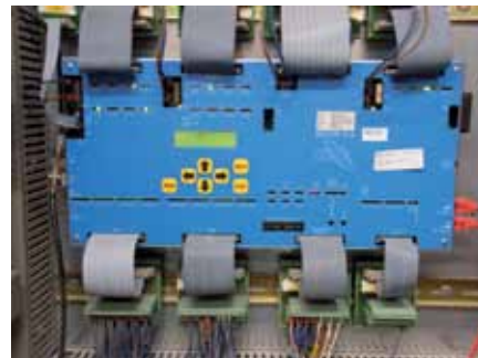
Rechnerausfälle aufgrund von Spannungsspitzen.
