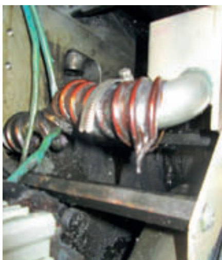
Stark verschmorte Kunststoffschläuche an den Waschbalken.
